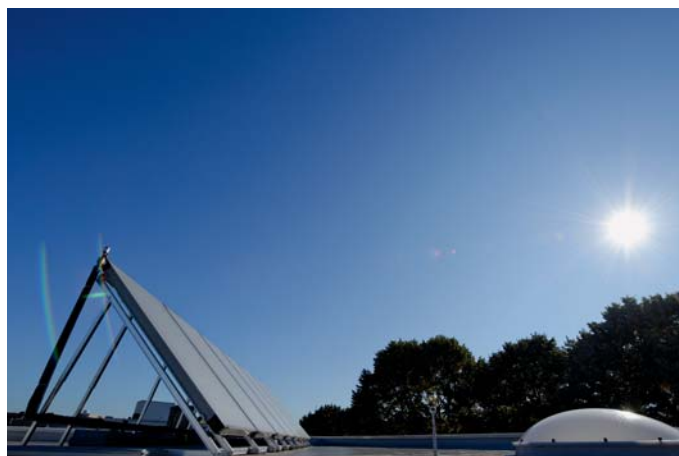
Acht Flachkollektoren von Junkers fangen die Sonnenenergie auf dem Dach ein.
