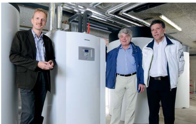
Das Herzstück des Wärmekonzepts ist die Wärmepumpe T 600 von Junkers. Im Bild von links: Junkers-Mitarbeiter Jörg Vorländer, Projektmanager Frank Sagenschneider und Installateur Alexander Mandara
