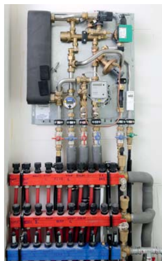
Im Plattenwärmetauscher (Kasten oben links) der Wohnungsstation wird über das Gegenstrom-Prinzip das Trinkwasser aus dem Pufferspeicher in heißes Frischwasser umgewandelt. Unten die Vor- und Rückläufe für die Fußbodenheizung
